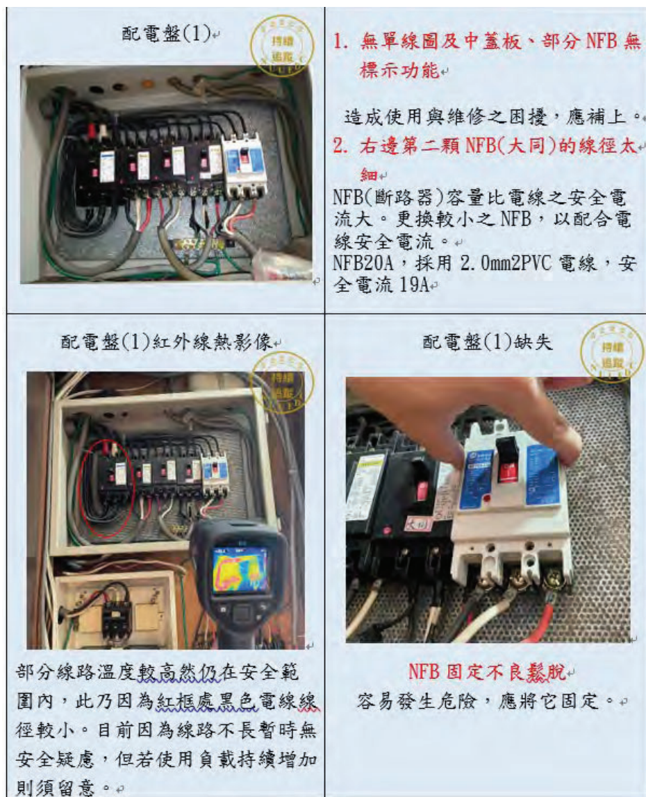
圖 124 電機系進行小型商業用戶用電健檢報告節錄之二
