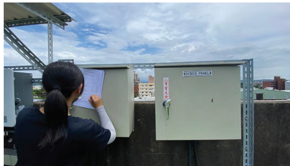
圖 125 電機系學生進行太陽能 DC 盤檢查
