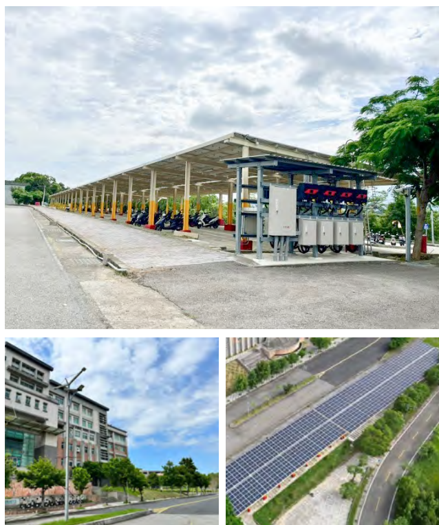
▲ 圖 6-3 節能相關措施一太陽能發電
