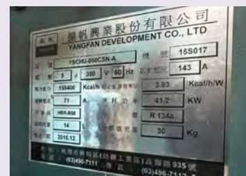
▲ 圖 7-136 冷卻系統設備
